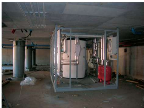
Figura 45 – Sottocentrale sospesa e solidale con la piastra antisismica “Cosbau SpA”.
