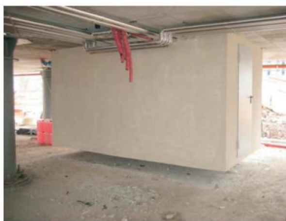
Figura 47 – Sottocentrale sospesa e solidale con la piastra antisismica “Cosbau SpA”.
