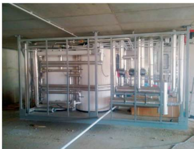
Figura 46 – Sottocentrale sospesa e solidale con la piastra antisismica “Cosbau SpA”.
